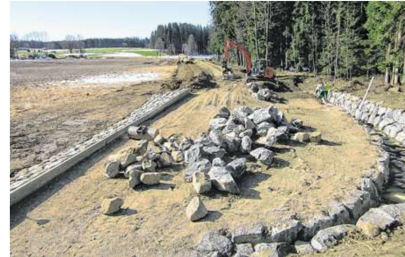
500 000 Euro kostet es, den Damm am Baldaufweiher bei Sulzschneid zu sanieren. Zu der Maßnahme gehört es auch, einen Überlauf (im Vordergrund) zu schaffen, falls nach starkem Regen zu viel Wasser ins Gewässer fließt. Ab Mitte Mai soll der größte Weiher im Stadtgebiet wieder aufgestaut werden. Foto: Andreas Filke
